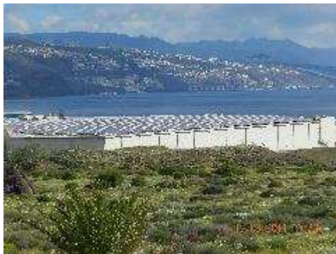
Solarinstallationen in Teneriffa. Qualitätskontrolle
