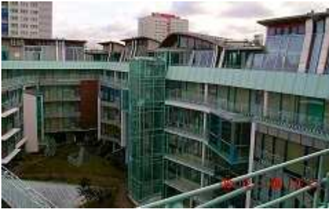
Berlin: Leckagen-Rissstellenfeststellung Dachterrassen
