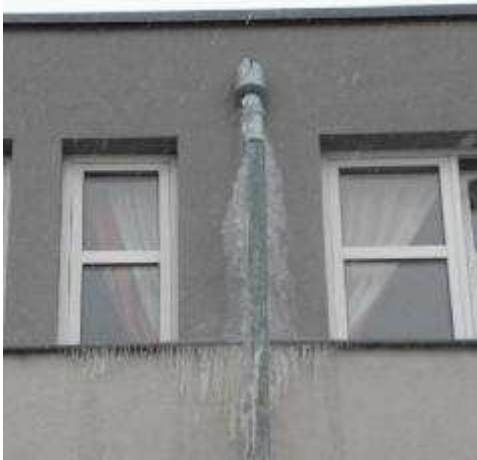
Eisbildung: Schmelzwasser hinterwandert Fassade, drückt zurück in den Dachaufbau und zerstört Fallrohre
