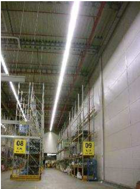
Kühlhalle Berlin: Mängelbeseitigung Tauwasserbildung
