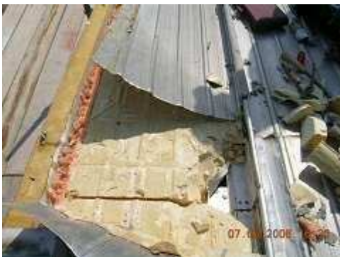
Beweisaufnahme - Wind-Luftundichtigkeit bei Großformat-Dachpaneelen
