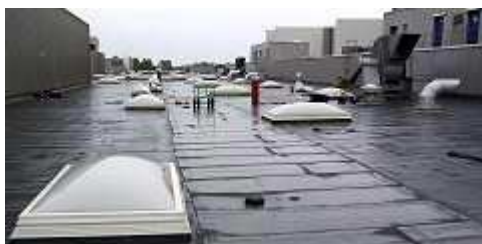
Berlin BMW-Produktionshalle ca. 10.000 m 2 : Mängelfeststellung, Sanierungsbegleitung, Qualitätssicherung, Abnahmen
