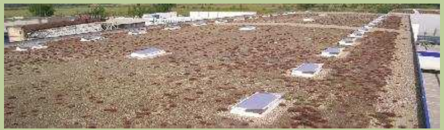
Logistikzentrum - Mängel an Einschicht-Extensivbegrünung mit Leichtsubstraten: Vegetationsausfall Versteppung Erosion Substratabschwemmung verursacht Gullyzuspülung, Pflanzendeckung im 4. Jahr 10-30 %
