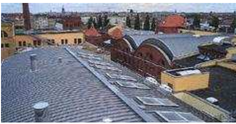
Berlin-Kulturbrauerei: Zustands- und Mängelgutachten Metalldächer. Schiedsgutachten zur Mängelbeseitigung
