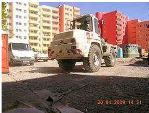
B-Wedding: Tiefgaragensanierung Gutachten Abdichtung
