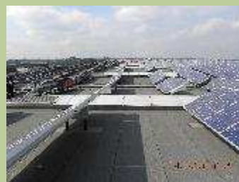
Solarinstallationen bei Brüssel (B) und Bordeux (F)
