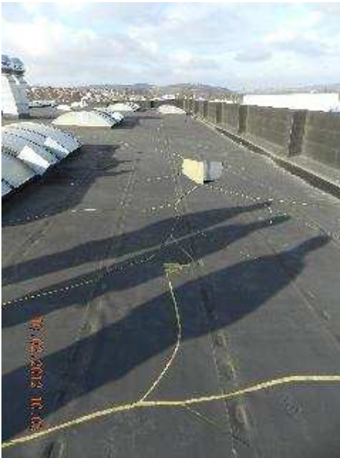
Fertigungshalle: Dachabdichtung durch Temperaturen unter minus 15° C gerissen. Kälterisse in Dichtbahn umfassen > 80 % der Dachflächen
