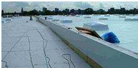
Berlin Tengelmann Logistikzentrum 30.000 m 2 : Baubegleitende Qualitätssicherung Abdichtung
