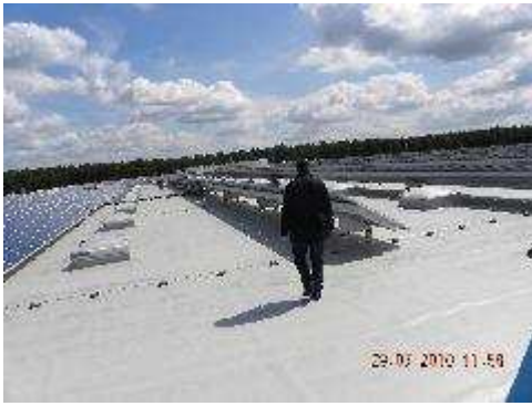
Solarinstallationen bei Berlin. Qualitätskontrolle
