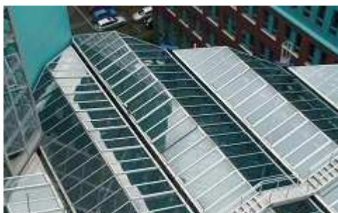
Berlin Glasdachkonstruktionen: Leckagen- Ursachenfeststellung
