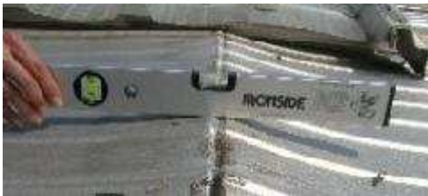
Logistikzentrum GB-Wales 30.000 m 2 Radial-Metaldach thermische Verformung
