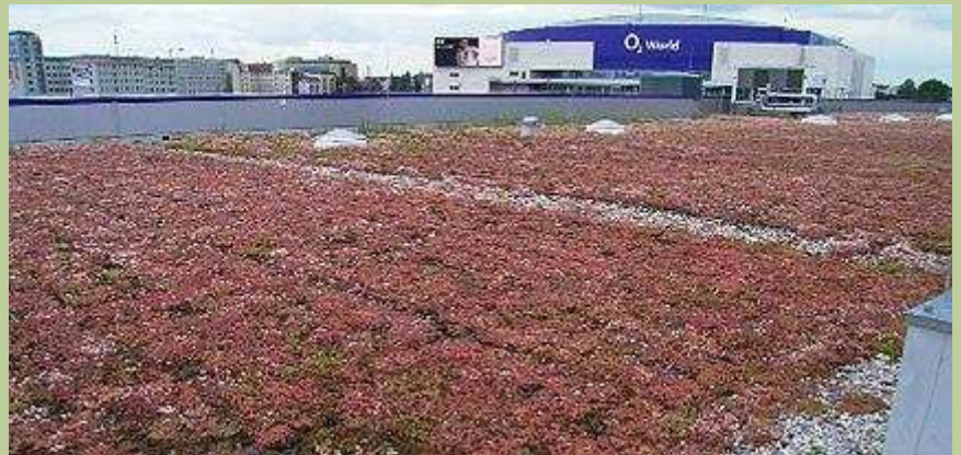
Metro Grossmarkt Berlin im 4. Jahr: Erhebliche Vegetationsmängel bei 7.000 m 2 Extensivbegrünung. Sanierungsgutachten
