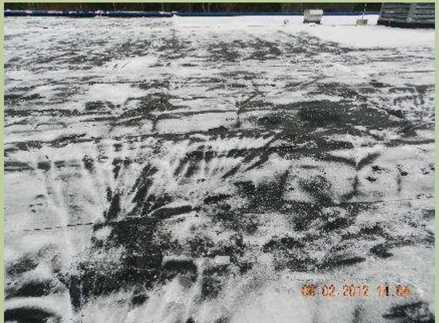
Winter 2012: Dachumfassende Risse in Dichtbahnen nach extremer Kälte unter -15° C bei einer 15.000 m 2 großen Dachfläche
