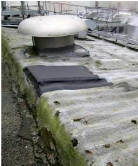
Werkhalle Tiernahrungsproduktion: Sprödrissige PU-Beschichtung nach 7 J.
