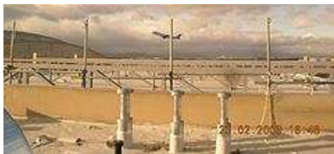
Fraport Cargo City Süd: Planungs- und LV- Beratung, Baubegleitende Qualitätssicherung Abdichtung und Dachaufbau
