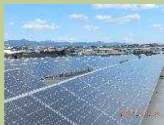
Solarinstallationen bei Malaga (ES) und Bordeux (F)
