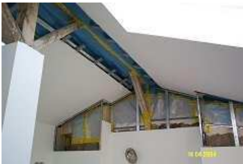
Mängelgutachten Phys. Dachgeschoss-Instandsetzung
