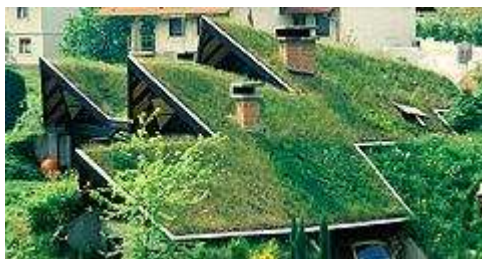
Solararchitektur Aschaffenburg 1979: 30- jähriges mängelfreies Jubiläum der naturnahen pflegefreien Steildachbegrünung über Umkehrdämmung nach von JDrefahl entwickeltem Verfahren.
