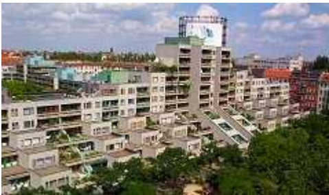
Berlin: Mängel- und Sicherungsgutachten Flachdächer und Dachterrassen
