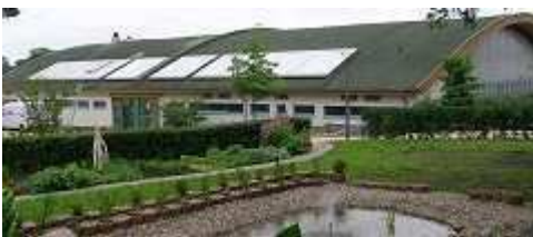
Sporthalle bei Berlin: Mängel- und Sicherungsgutachten Polyurethandachbeschichtung
