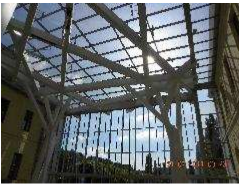
Berlin Jüdisches Museum: Tüwässer- und Eisschäden im Glasdach und -fassade. Rissstellenfeststellung und Sicherungsgutachten
