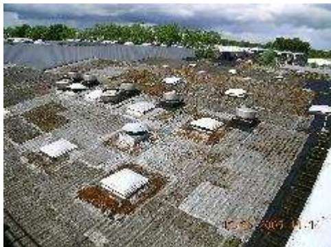
Nicht nachhaltige Sanierungsversuche mit PU-Beschichtungen
