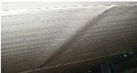
Mängelfeststellung und Instandsetzungsgutachten ü. thermische Verformungen in Sandwichpaneel-Metaldach mit Leckagen
