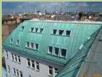
Mängelfest. Materialun.-träglichkeiten Bitumen - Kupfer
